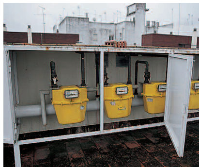
20. BATERÍA DE CONTADORES Y LLAVES DE CORTE.
