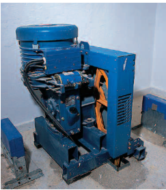
13. MAQUINARIA DE ASCENSOR.
