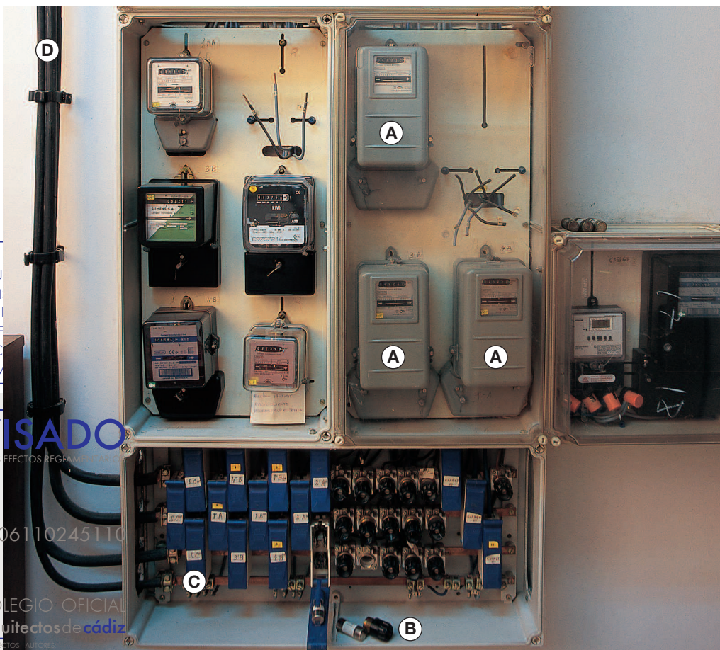
12. CENTRALIZACIÓN DE CONTADORES ELÉCTRICOS: A. Contadores individuales. B. Fusibles desmontados para su sustitución. C. Fusible instalado. D. Línea repartidora.
